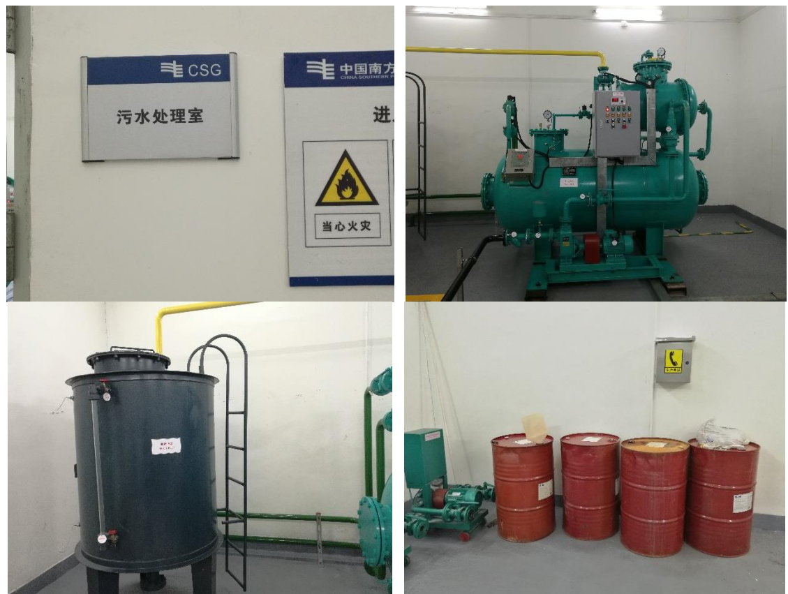
图 4.2-32 地下厂房含油废水处理室
