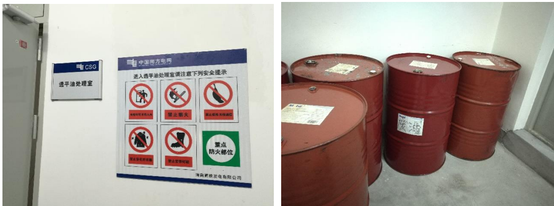
图 4.2-31 透平油处理室的油罐
