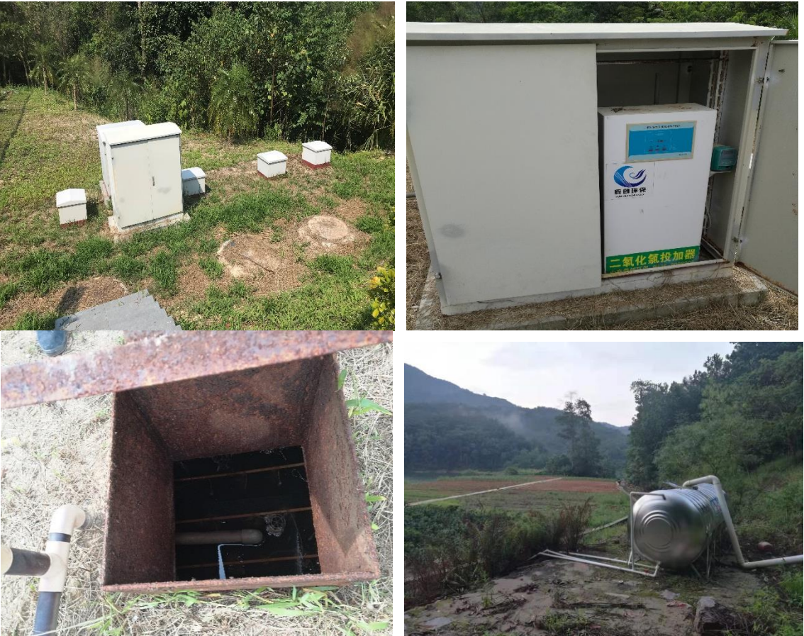
设备运行记录
