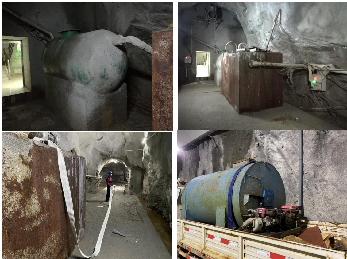
图 4.2-30 地下厂房生活污水处理设备
