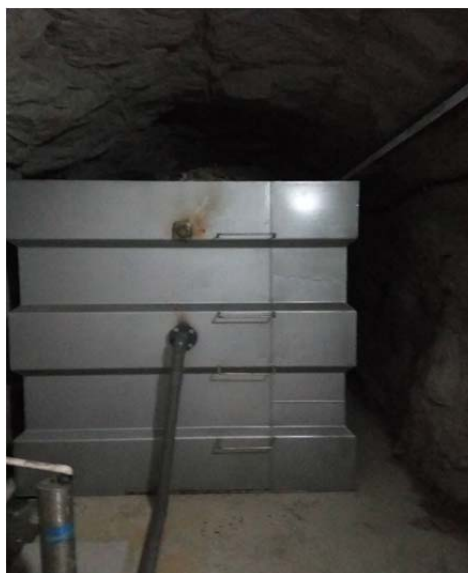
地下厂房生活污水处理一体化设施
