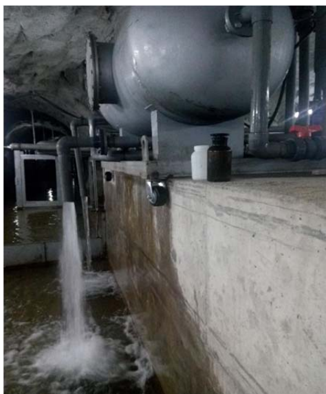
地下厂房含油废水处理设施
