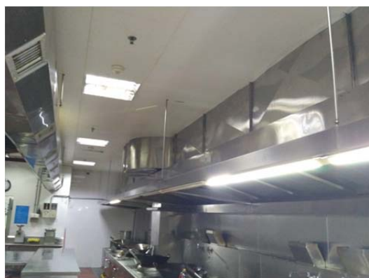
厨房油烟收集处理系统
