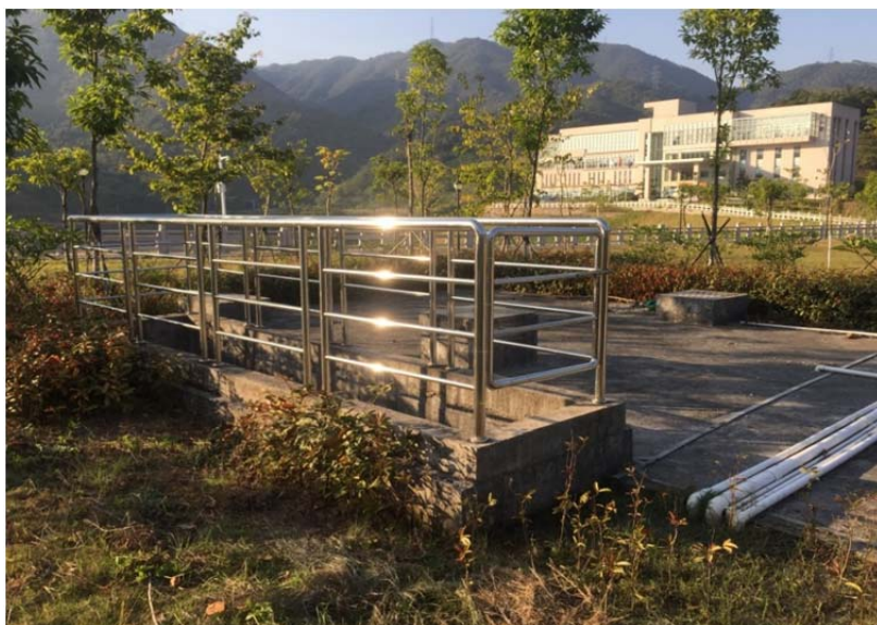
图 5-30 管理中心地下一体化生活污水处理设施
