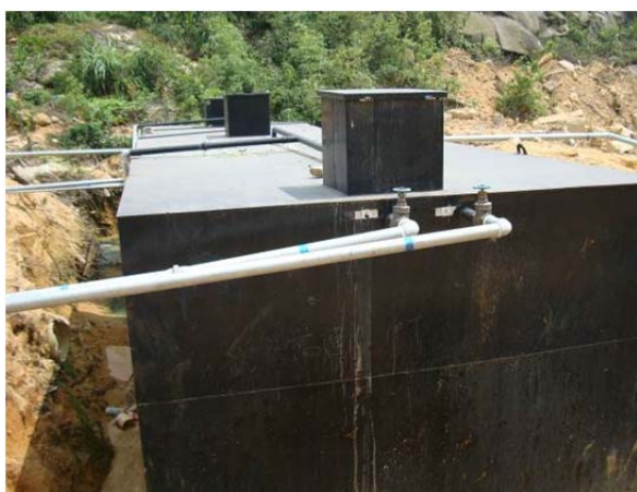
上库葛洲坝营地地埋式污水处理装置
