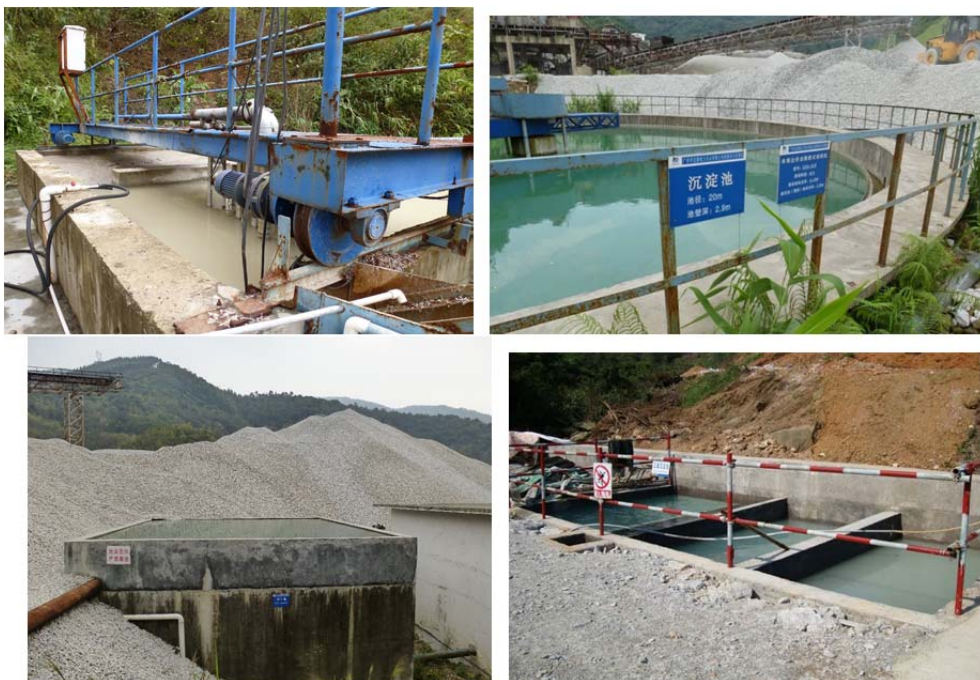
图 5.2-1 砂石料加工系统废水处理系统现场照片
