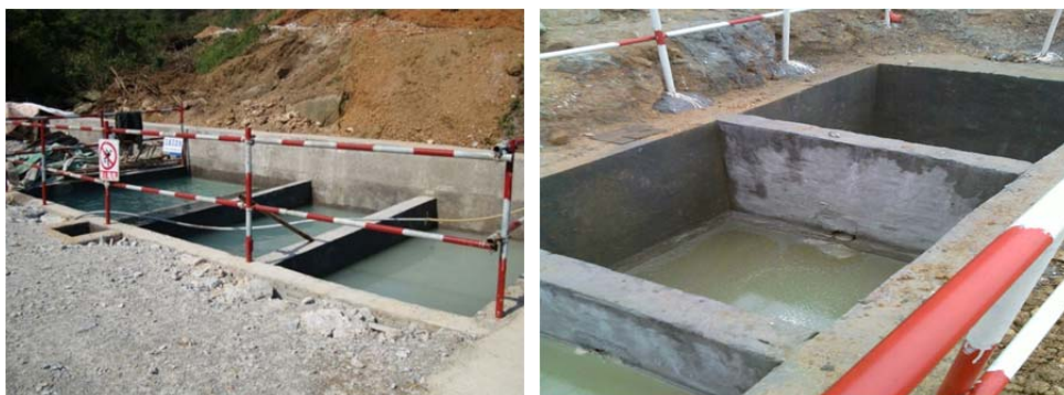
图 5.2-3 2# 施工支洞三级沉淀池
