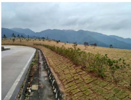
上下库区连接道路排水沟及绿化
