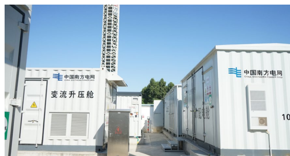
东莞黎贝电池储能站
