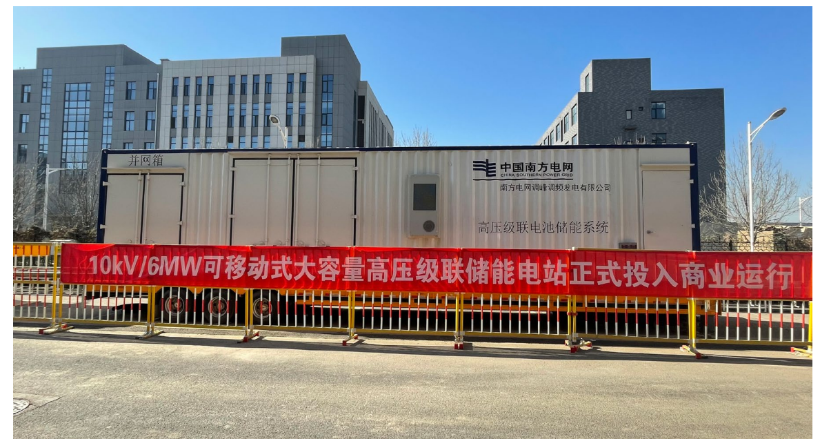
河北保定电池储能站
