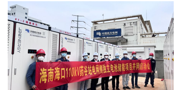
海口药谷电池储能站
