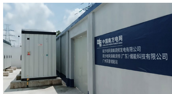
广州芙蓉电池储能站
